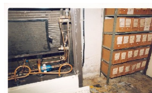
FIG.3 - Sala do ar-condicionado
