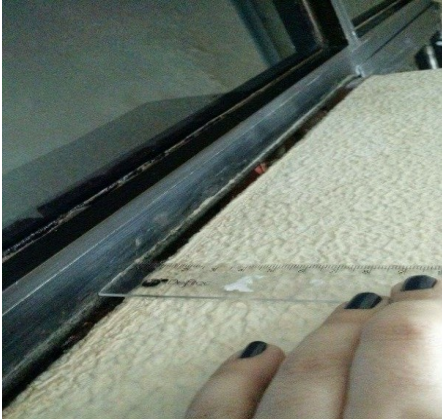
Figura 11 - Fenda existente na janela da Sala B (2016)
