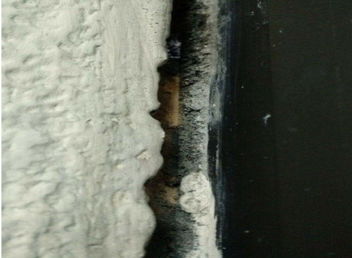
Figura 10 - Fenda existente na janela da Sala A (2016)
