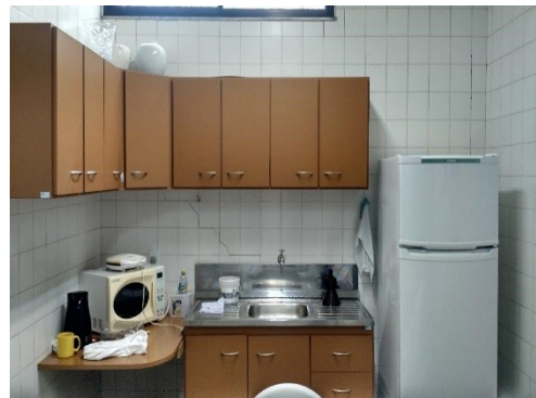
Figura 12 - Cozinha de madeira com infestação por cupim (2016)
