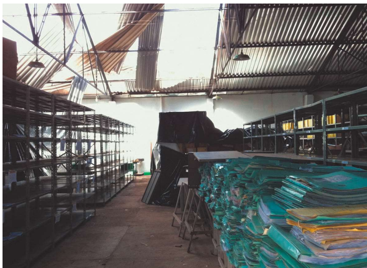
Área de arquivo destelhada e acervo exposto a intempéries (chuva forte). Todo o acervo foi recuperado e remanejado para novo espaço de guarda.
